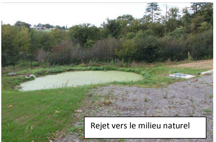
Chasse à eaux claires et 2 ème étage de filtration
